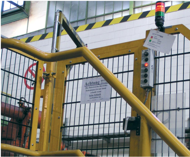
Bild 2. Der Zugang zu der Seitenstanze ist mit einer Sicherheitstür mit Anmeldeeinheit abgesichert
